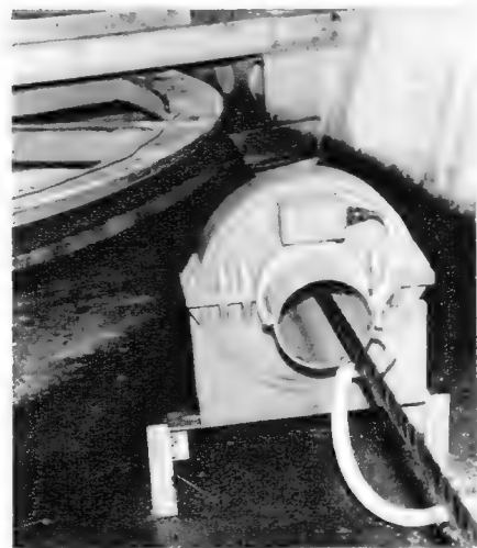
Der Seil-Durchlaufüberträger der elektronischen Seilbahn-Signalanlage am Dachstein. Die Signale für die Kabinen werden induktiv über das Zugseil übertragen, und man kann sich ebenso auch telefonisch mit den Stationen unterhalten
